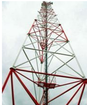
Figura 26: imagen referencial de torre de comunicaciones
